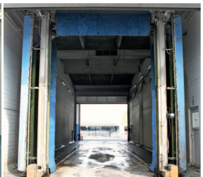
Moderne Waschanlage mit biologischer Wasseraufbereitung
